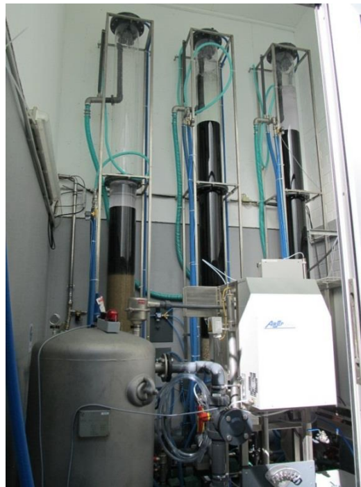
Filtersäulen mit granulierter Aktivkohle
