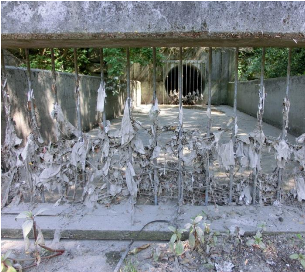
Zulauf RBF von RÜB aus
