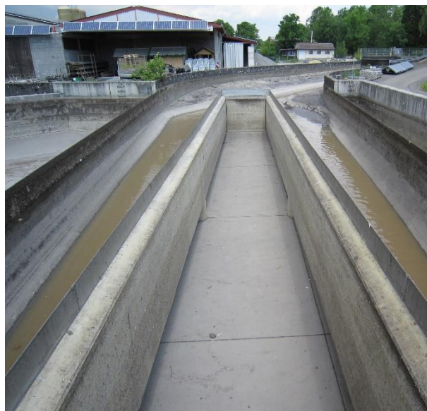
Gerinne zur KA / Überlauf in das RÜB
