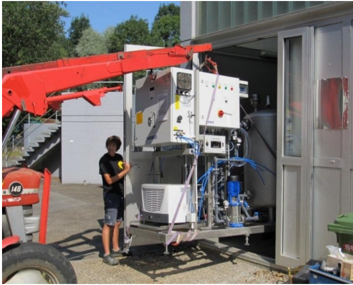
Ozonanlage / Einbau in Versuchsanlage
